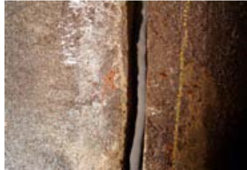
2. Verkrustungen durch Undichtheiten
