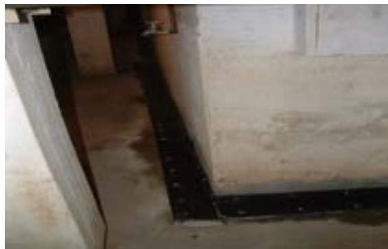
6. Fertig montierte Abdeckungen in L-Form, Befestigung mit Edelstahlschrauben. Abdeckung bleibt elastisch, kann Bauwerksbewegungen bis zu 10 mm ausgleichen
