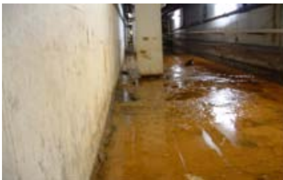
1. Vorher: Eindringendes Grundwasser durch Beckenfuge und Außenwandkehlen führt zu nachhaltigen Betonschäden
